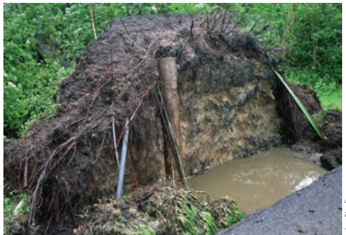
Gaslek en kabelbreuk door omgewaaide boom.
